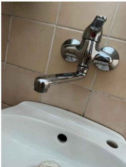
Obr. Detail výtokové armatury
