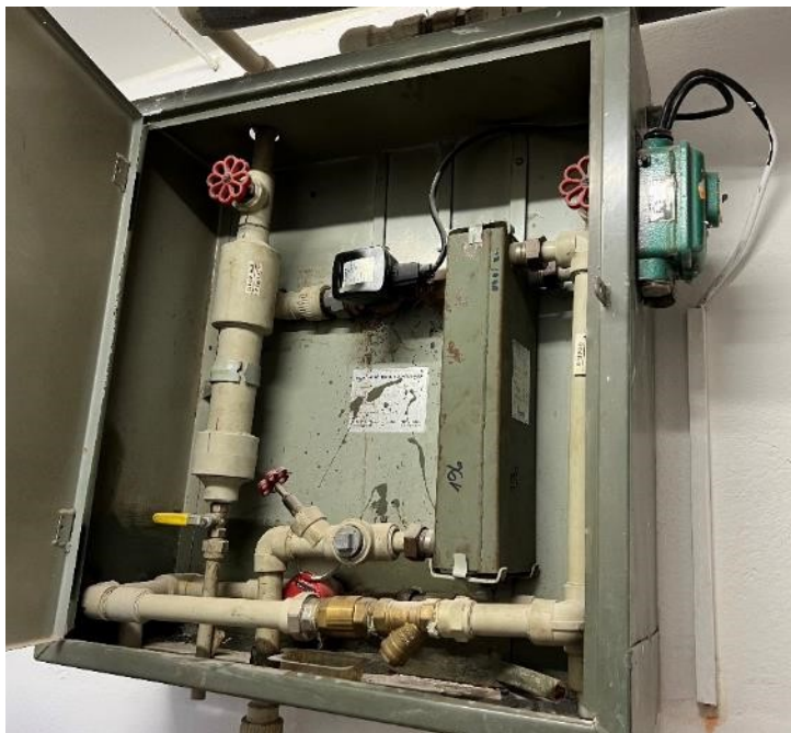
Obr. Výměňník ohřevu teplé vody
