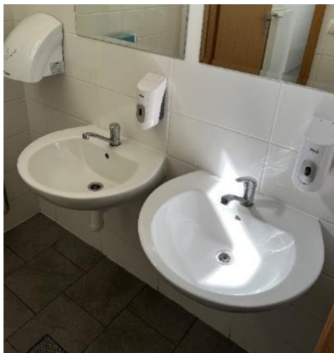
Obr. Detail výtokové armatury
