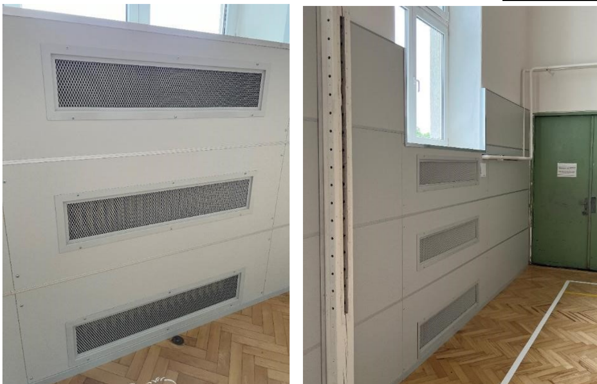
Obr. Detail OT v tělocvičně
