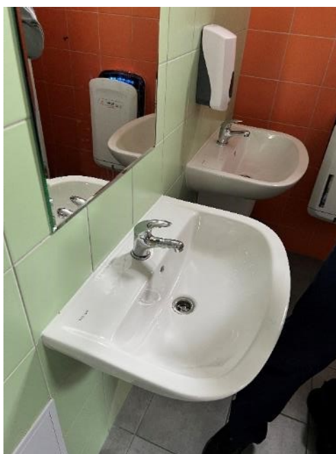
Obr. Detail výtokové armatury
