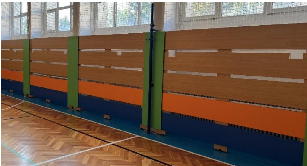
Obr. Detail OT v tělocvičně
