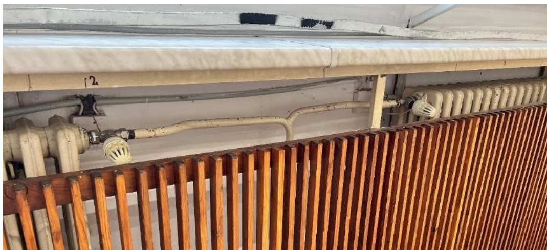
Obr. Detail OT v tělocvičně
