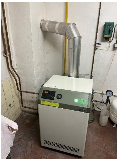
Obr. Zdroj tepla pro budovu Dílen
