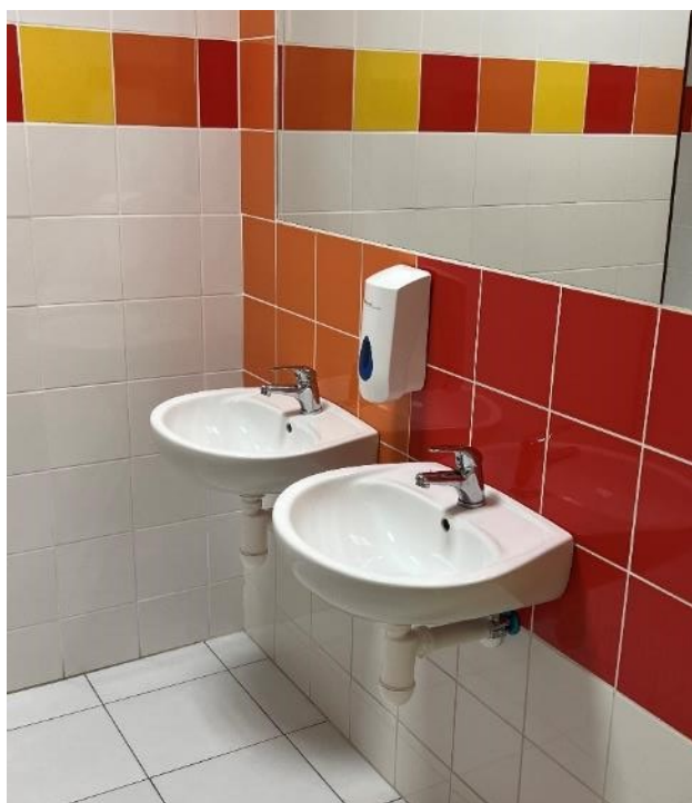
Obr. Detail výtokové armatury
