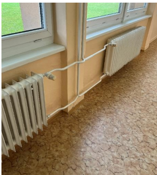
Obr. Detail OT v budově školy
