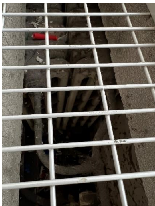
Obr. Detail OT v tělocvičně
