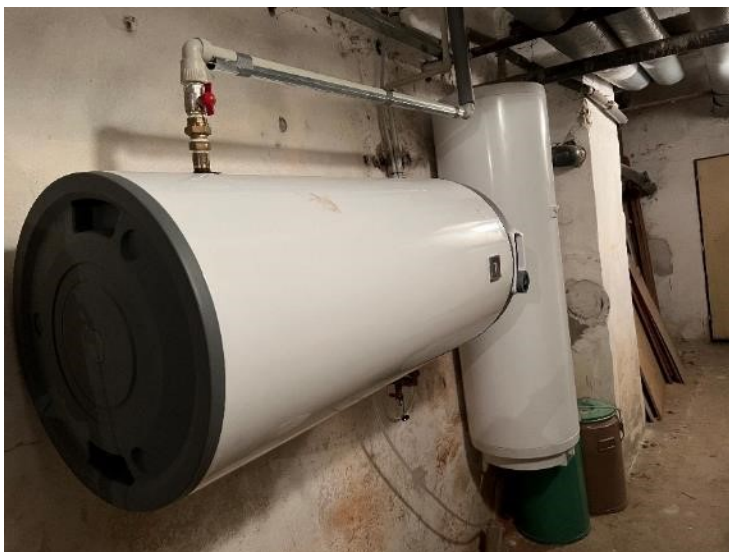
Obr. Ohřivač teplé vody
