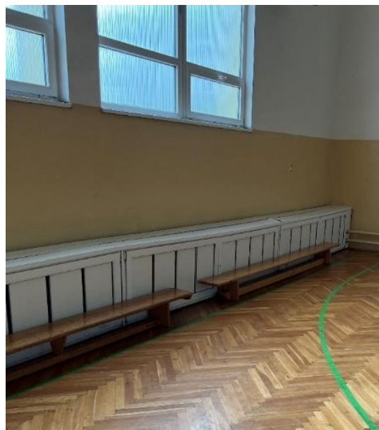
Obr. Detail OT v tělocvičně
