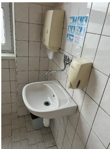
Obr. Detail výtokové armatury
