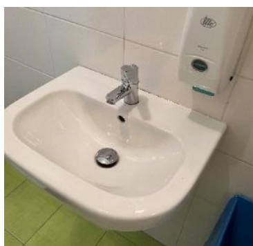
Obr. Detail výtokové armatury
