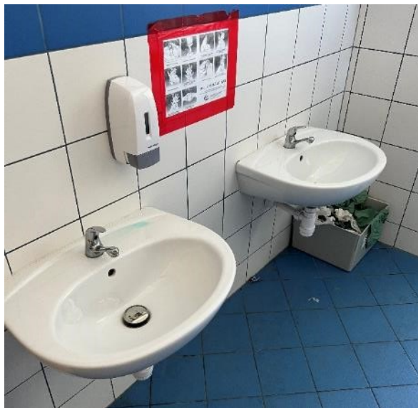
Obr. Detail výtokové armatury
