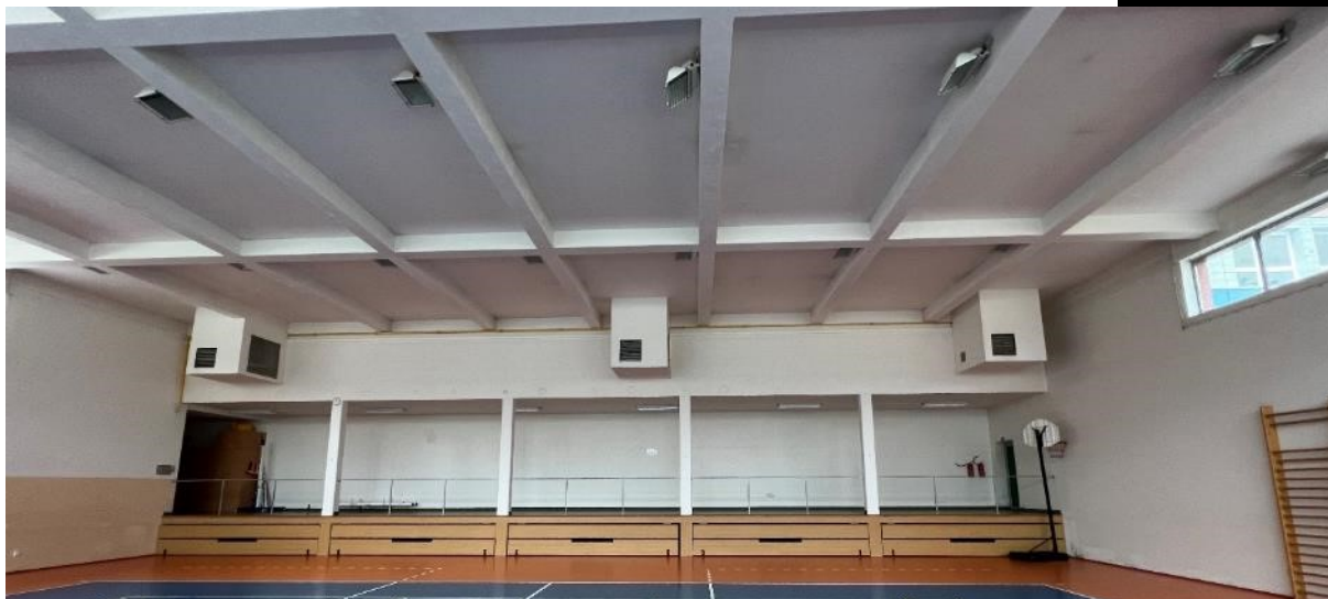
Obr. Umístění vytápěcích jednotek Sahar v tělocvičně
